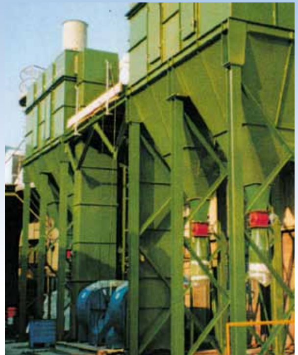
Odprašovací zařízení s R+B filtračními vložkami.
